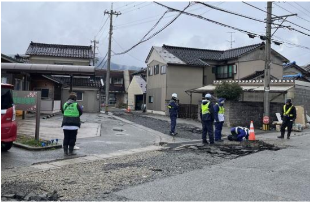
輪島診療所前の道路も陥没、隆起で通行不能に
